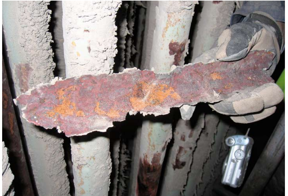
KUVA 3. Kuvassa nähdään tulistimen pinnalta helposti irronnut tuhkakkerros, jossa ilmenevät ruosteen monet värit. Tällainen sakkakerroksen helppo lohkeaminen on usein merkki alkavasta kloridikorroosiosta. Kuva A. Klarin.
